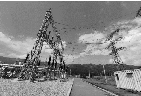
Subestación Palenque, ubicada en Bucaramanga- Santander
